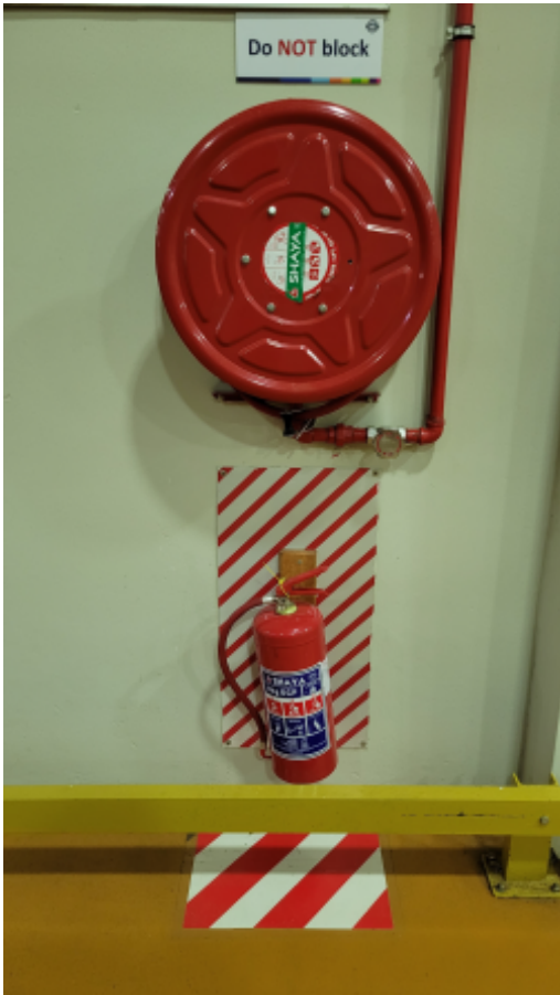
Utilities Area fire suppression system.jpg
