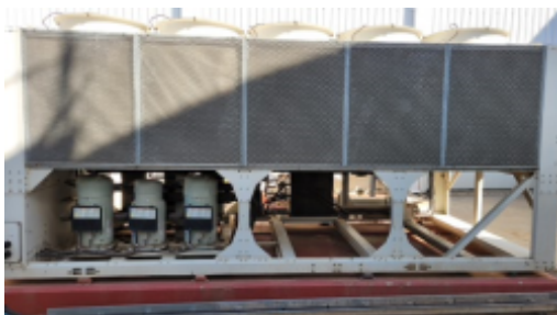
Site HVAC chiller.jpg
