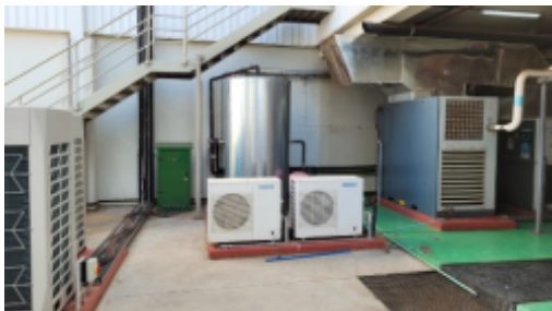
Site HVAC system.jpg
