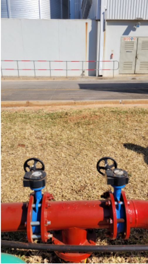
Site water meters.jpg
