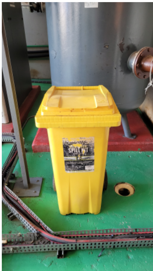
Utilities area spill kit.jpg
