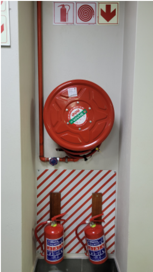
Office fire suppression system.jpg
