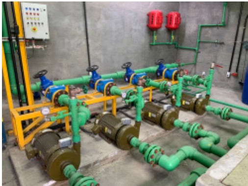
sistema de bombas y tuberías.jpg
