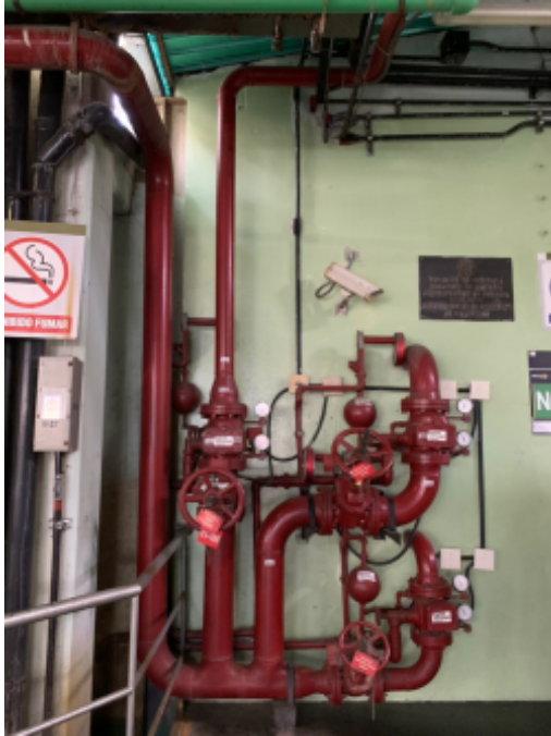
Instalaciones contra incendios.jpg
