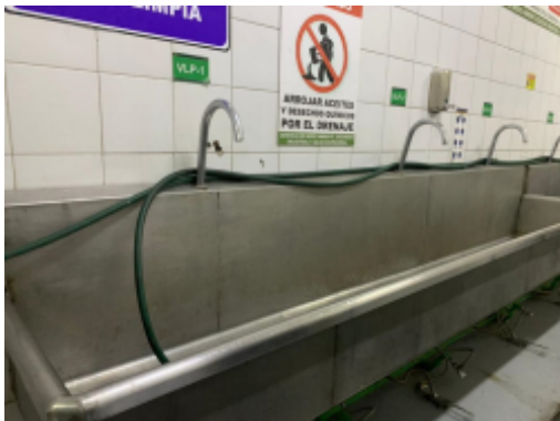
Zona de lavado con pedales.jpg
