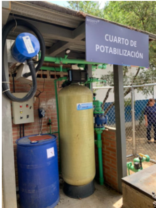
Zona de filtros.jpg
