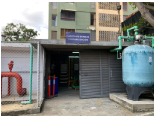
Cuarto de bombas.jpg
