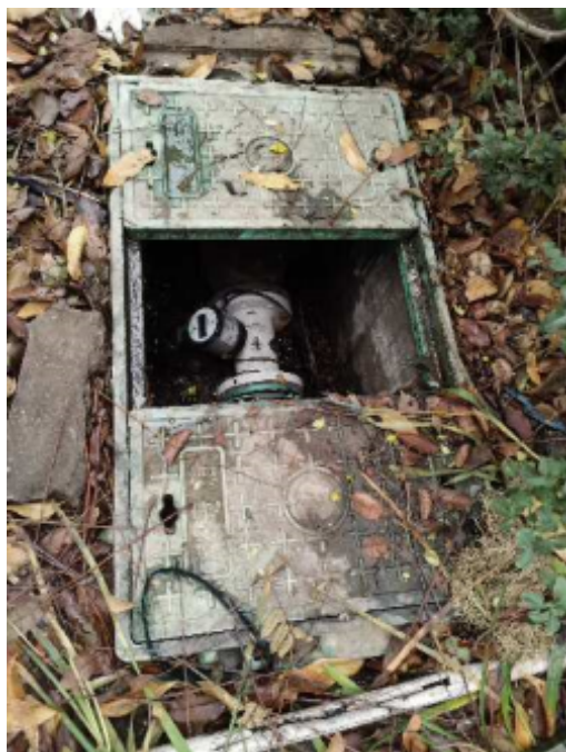
Water meter-Tuanjie Plant.jpg
