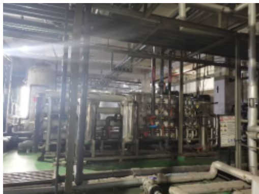
The water purification facilities-Tuanjie Plant.jpg
