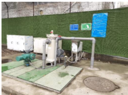
Rain water discharge point-Tuanjie Plant.jpg
