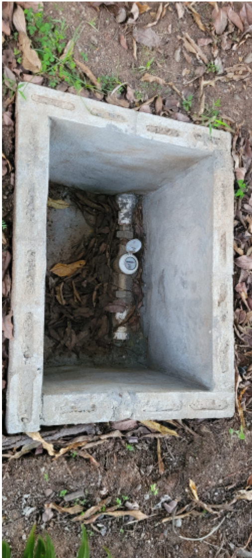
New meter for input water.jpg
