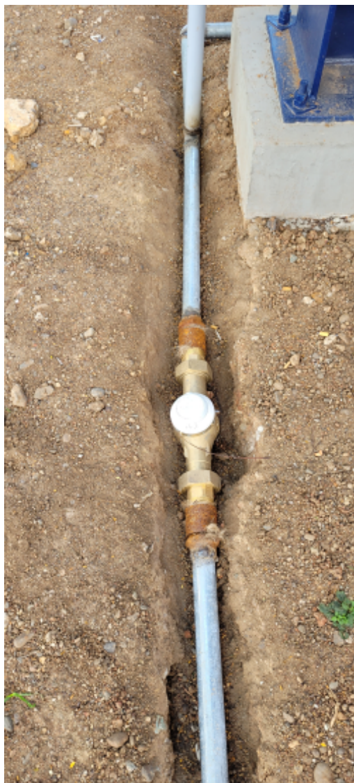
Meter at new boiler.jpg
