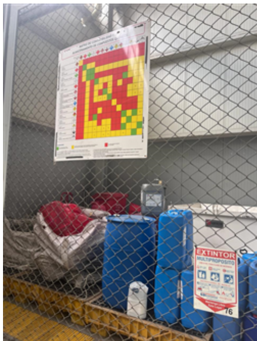
Almacenamiento residuos peligrosos.jpeg
