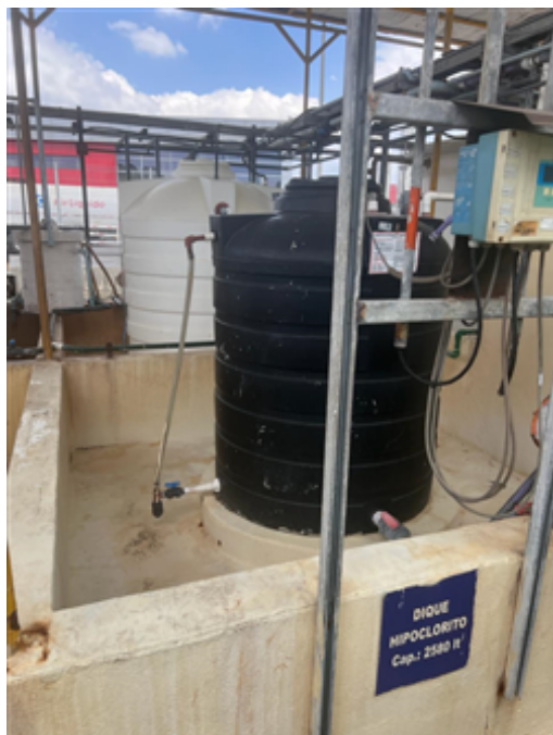
Contención sustancias PTAR 3.jpeg
