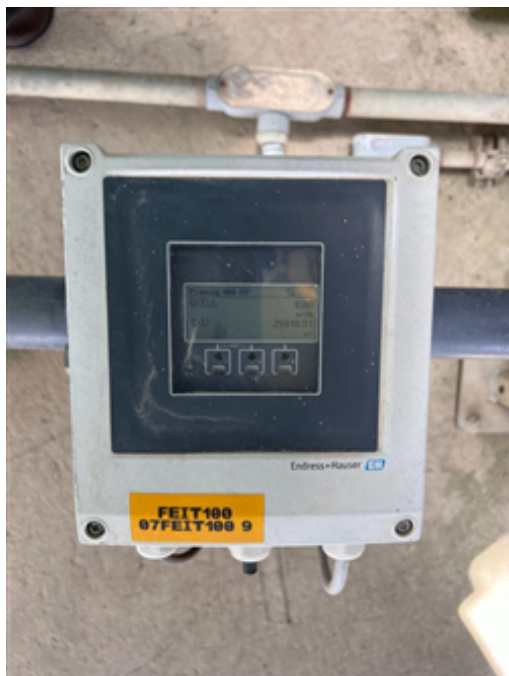
Contador de agua.jpeg
