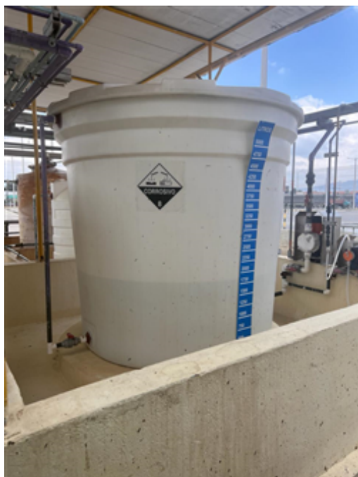
Contención sustancias PTAR 2.jpeg
