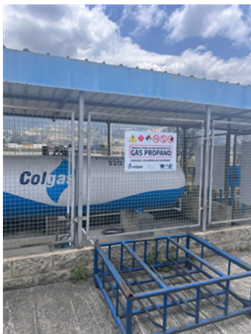
Suministro gas natural.jpeg
