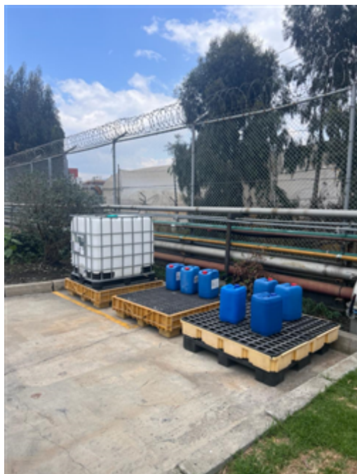
Contención sustancias PTAR.jpeg
