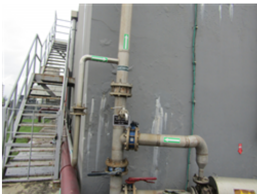
7. GIDC Rawwater Inlet line.JPG
